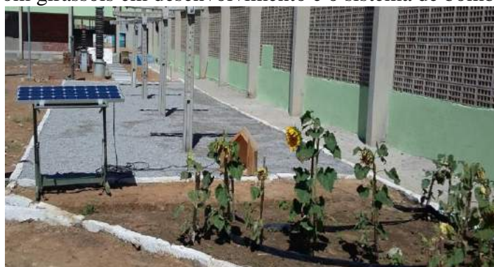
Figura 6: Canteiro com girassóis em desenvolvimento e o sistema de bombeamento fotovoltaico.
