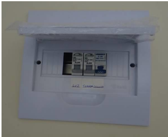
Figura 2 - Quadro de distribuição finalizado: Visita técnica.
