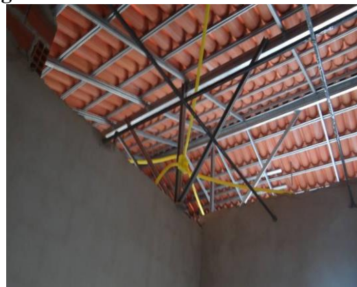
Figura 1 - Eletrodutos no teto: Visita técnica.
